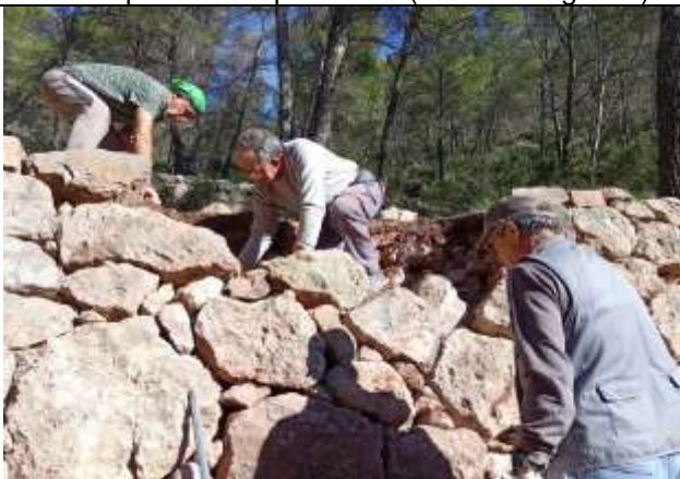
Una vez colocadas las piedras del paramento de fachada, el interior del muro se rellena de ripios para dar consistencia al dique de contención.
